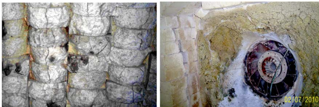
Рис. 1. Эрозия футеровки сушильной печи на ОАО «Доломит»
