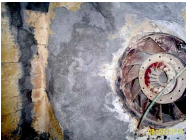
Рис. 2. Вид покрытия, нанесенного на поверхность горелочного камня после 7 суток непрерывной работы печи
