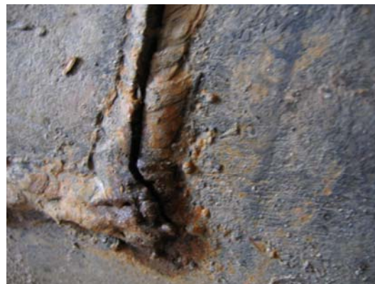
Рис.2. Продольные трещины в сварном шве.
