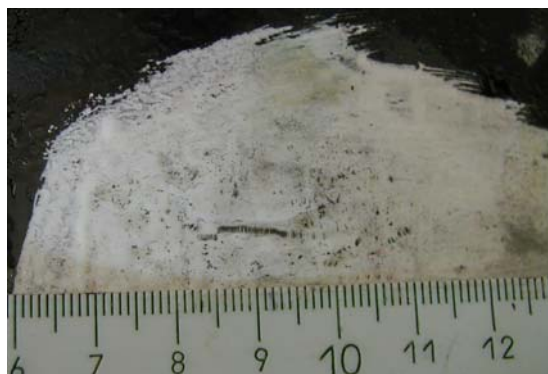
Рис. 4. Магнитопорошковая дефектоскопия наружной поверхности трубы.
