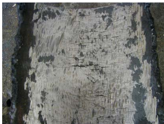
Рис. 2. Внутренняя поверхность трубы после зачистки.
