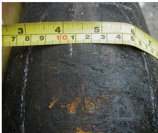
Рис.1. Сквозная трещина на наружной поверхности трубы.
