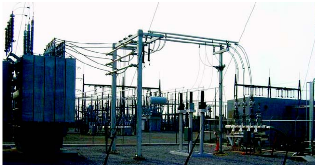
Рис.1. ВТСП-кабель длиной 200 метров на электрической подстанции в США [1].
