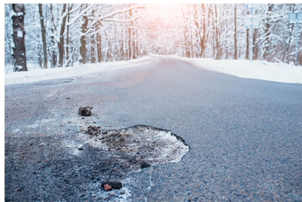
Рис. 1. Ритвины в дорожном покрытии.
